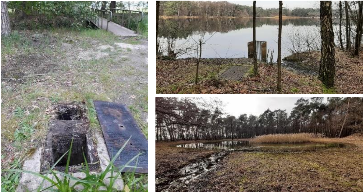
Figuur 47: Links: Inlaatpunt Colateur richting E3-Put, Rechtsboven: Westelijk uitlaatpunt Colateur, Rechtsonder: Overloop uit pool.
