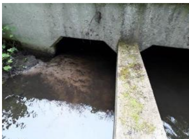
Figuur 45: Onderdoorgang snelweg E34 met keermuur; Links Colateur, Rechts afwateringsgracht naar het Loeijens Neetje.
