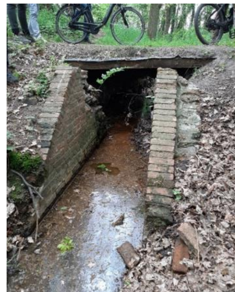
Figuur 118: Duiker onder wandelpad in slechte staat.
